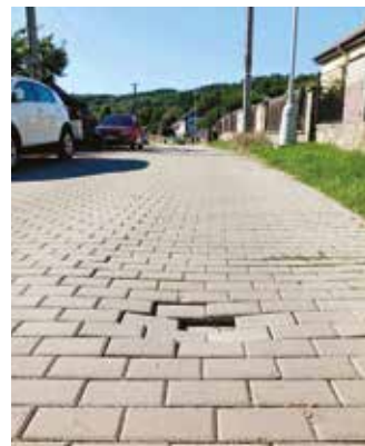
Současný stav komunikace Pod Hrádkem II
